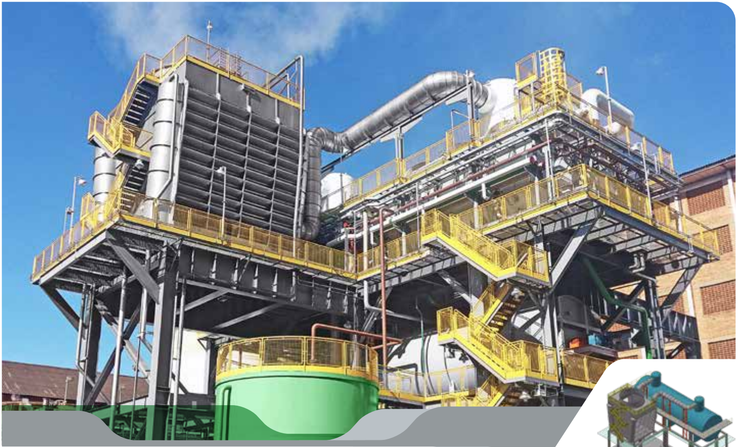
Condensador Evaporativo instalado em Cozedor Contínuo com capacidade de 2.800 HL Evaporative Condenser installed on Continuous Vacuum Pam with capacity of 2.800 HL Condensador Evaporativo instalado en Cocinador Continuo con una capacidad de 2.800 HL
