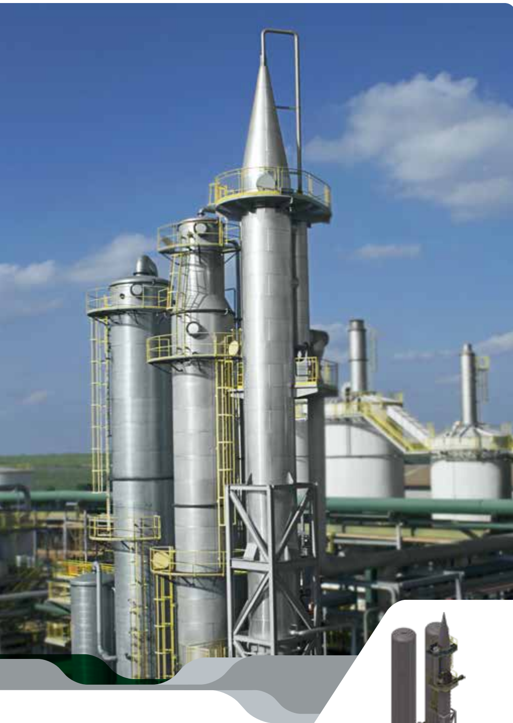
Reboiler com capacidade diária de 500 m 3 de produção de etanol Reboiler. Daily capacity of 500 m 3 of alcohol production Reboiler con capacidad diaria de 500 m 3 de producción de etanol
